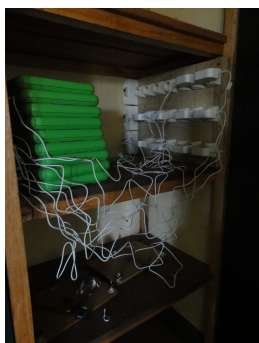
Photo B.1 – Armoire d’une salle de classe école publique pour ordinateur XO Cameroun
